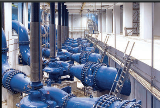
Pumpen und Kompressoren
